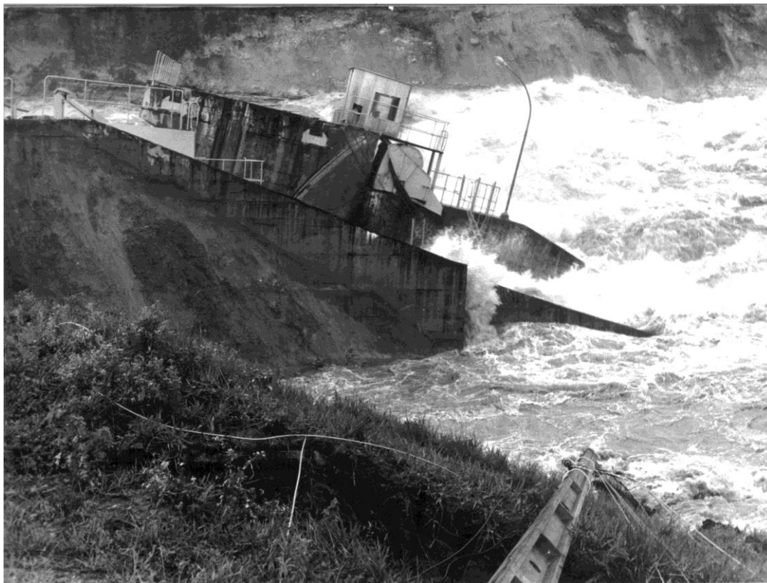
Figura 25 – Ruptura no contato entre o muro direito e o vertedouro, Fonte: Erton, 1999.
