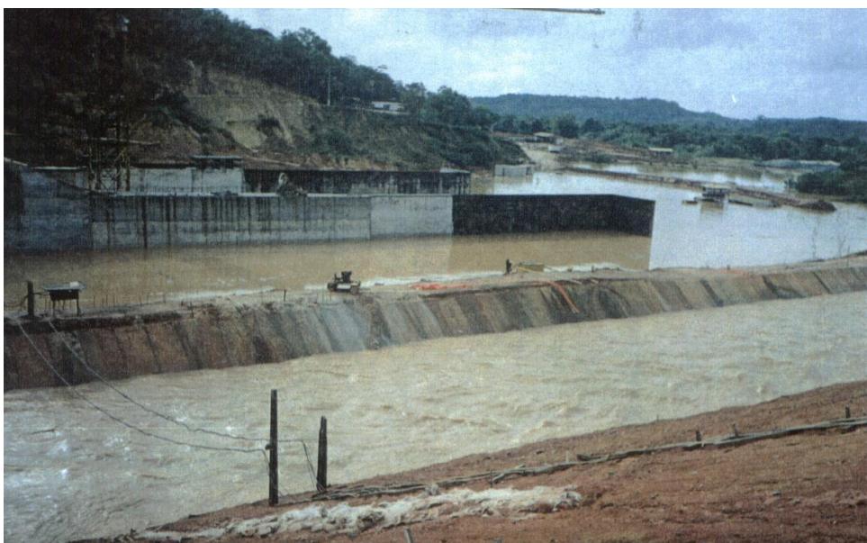
Figura 30 – Área protegida pela ensecadeira alagada devido forte chuva, Fonte: Erton, 1999.
