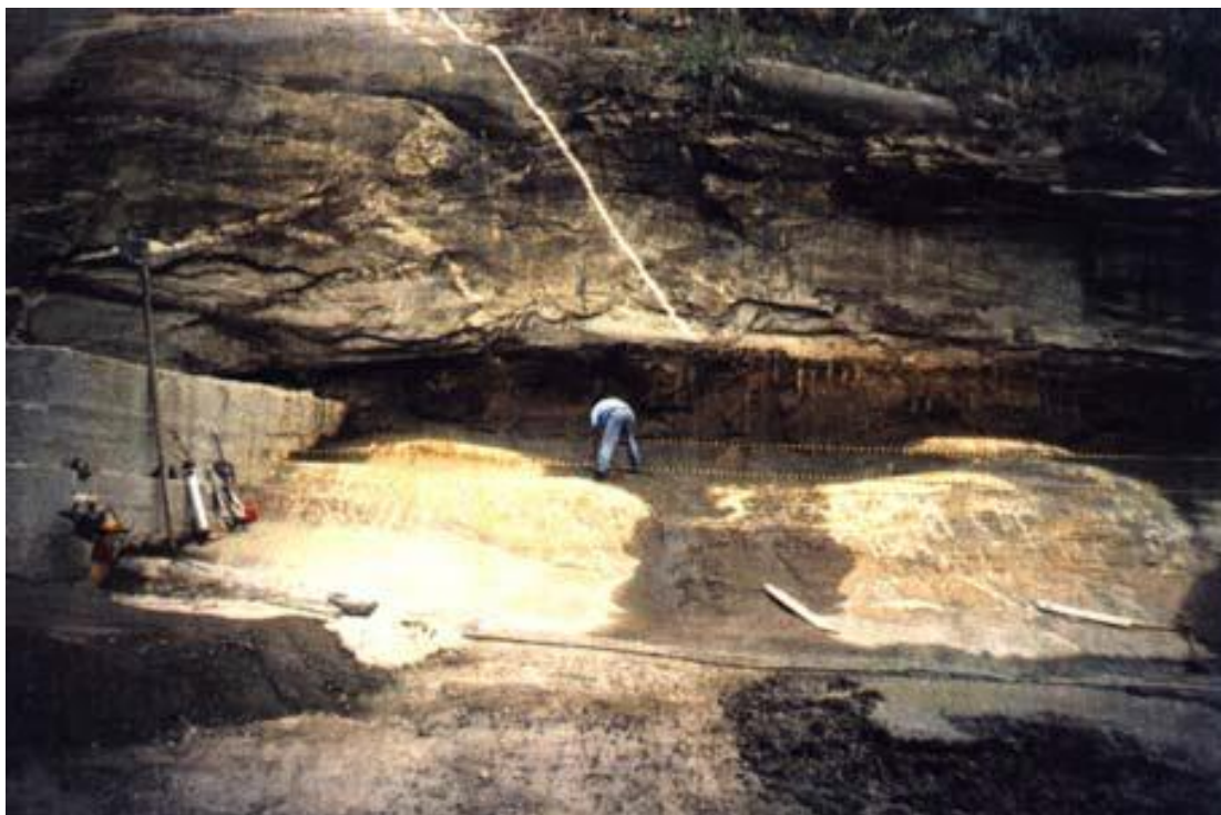
Figura 18 - Falha aflorante nas escavações da ombreira esquerda, Fonte: Parecer técnico sobre as causas da ruptura da barragem de Câmara, 2004.
